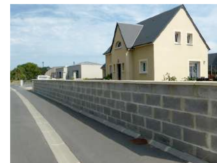
😞 Muret de clôture non enduit
